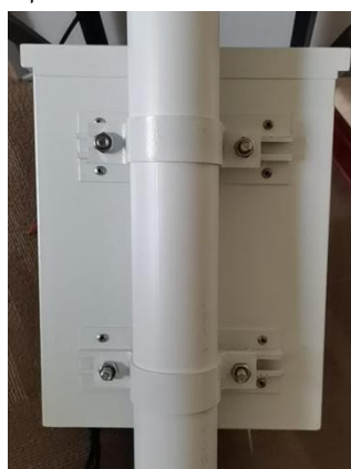
安装完成背面图
